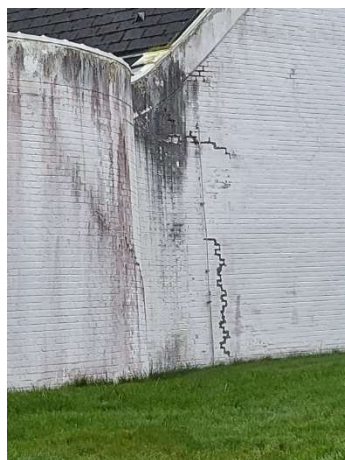
Gebäudeschaden an der Taufkapelle der Auferstehungskirche Ellenberg (Foto: Kerstin Runge)
